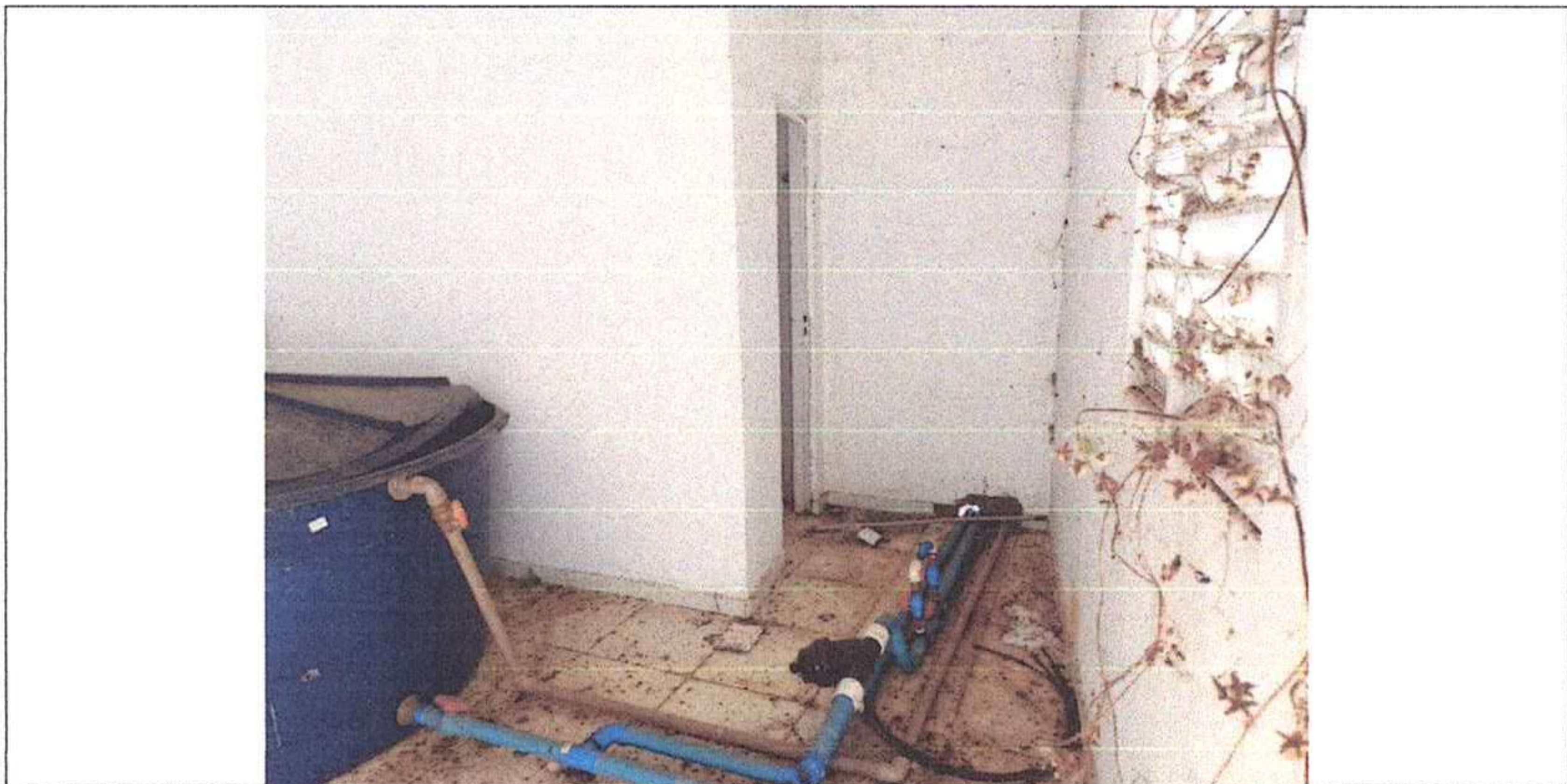
FOTO 04 – CASA DE BOMBAS
