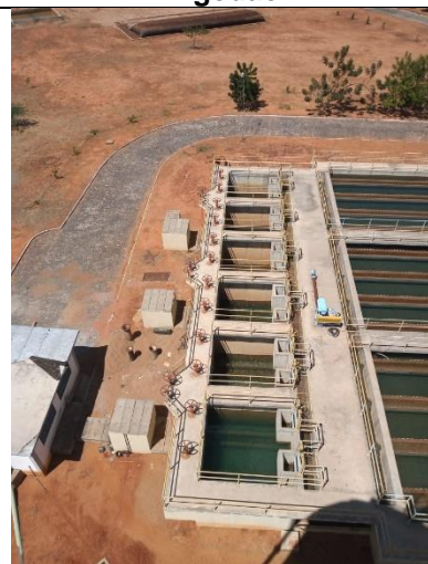
Figura 12 – Vista parcial dos filtros da ETA do Algodão
