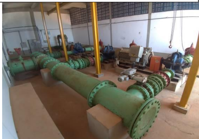
Figura 22 – Conjuntos moto-bombas da Estação Elevatória de Água Tratada 2 do Sistema do Algodão
