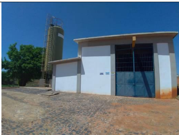
Figura 21 – Estação Elevatória de Água Tratada EEAT 2 do Sistema do Algodão
