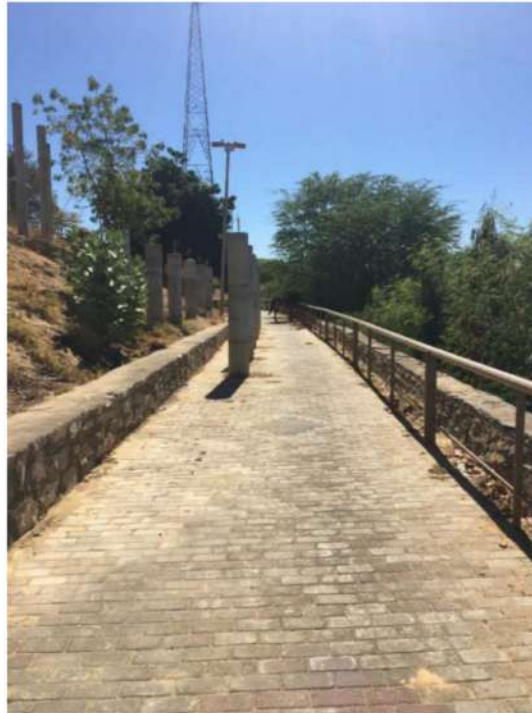
Figura 16 - Pilares de pergolado em local não projetado Fonte: Prefeitura Carinhanha
