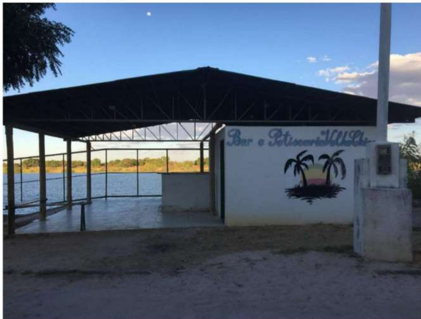
Figura 8 - Cobertura da Sede dos Pescadores destoante da projetada Fonte: Prefeitura Carinhanha
