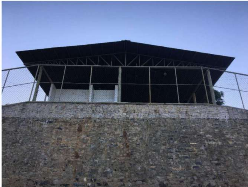
Figura 10 - Trecho sem contenção escalonada projetada Fonte: Prefeitura Carinhanha
