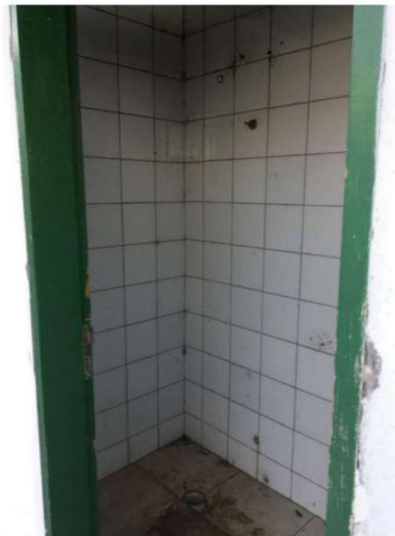
Figura 9 - Sanitário da Sede dos Pescadores Fonte: Prefeitura Carinhanha
