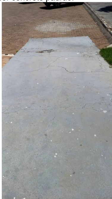
Imagem 01 – Rampa de acesso principal danificada e sem direcionamento tátil.
